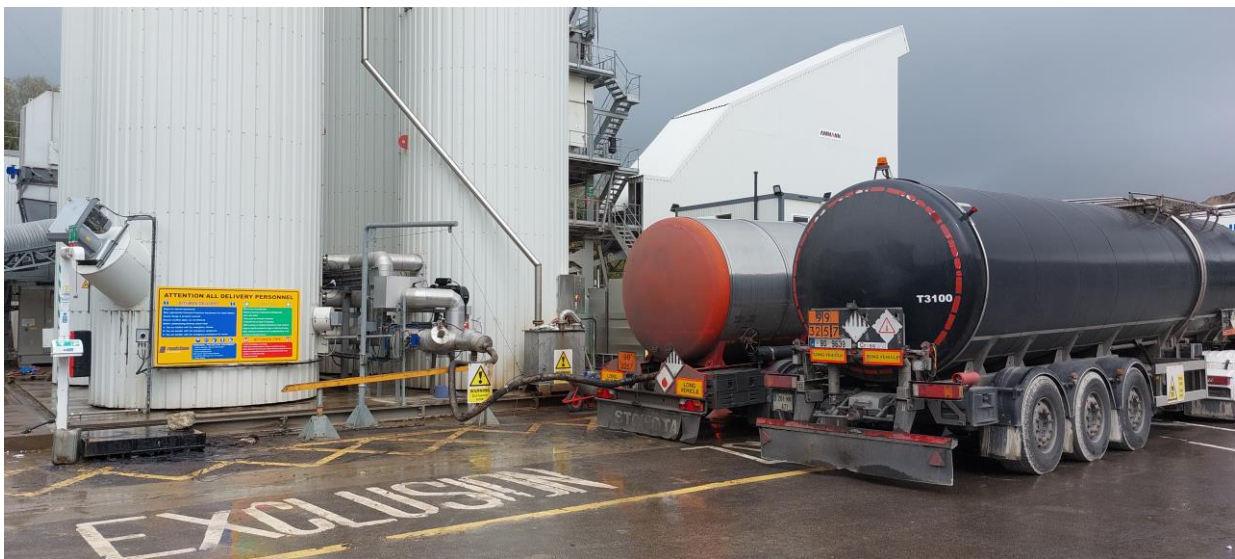
Podczas roztankowywania cystern asfalt jest automatycznie neutralizowany. Zdjęcie z firmy ROADSTONE pod KILLARNEY, Irlandia.
